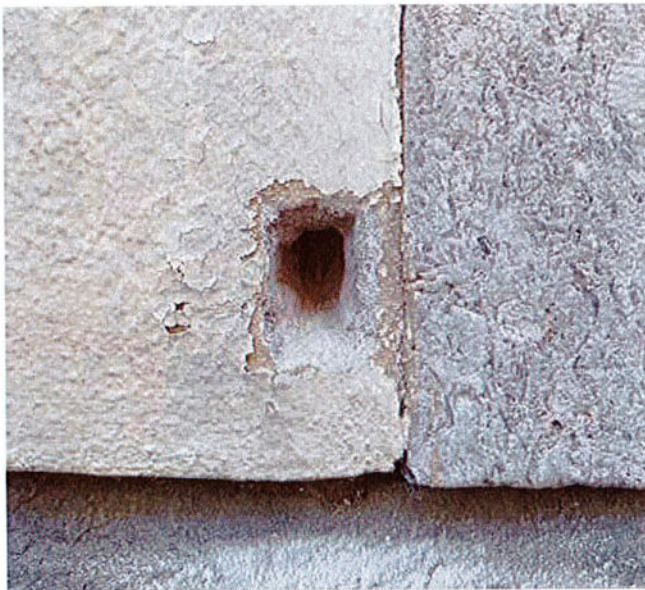
Foto 1: Pianoterra - parte sinistra della facciata -intonaco ridipinto in una tonalità più chiara, sopra al colore giallo che caratterizza l'intero edificio. Sotto il colore giallo troviamo lo strato cementizio frutto del totale rifacimento dei fondi. Lo spessore supera anche i tre centimetri.
