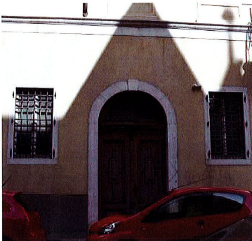
Foto 15: Portone ligneo minore, in pessimo stato di conservazione, forse a causa dell'utilizzo di una vernice poliuretanica, ora completamente degradata.
