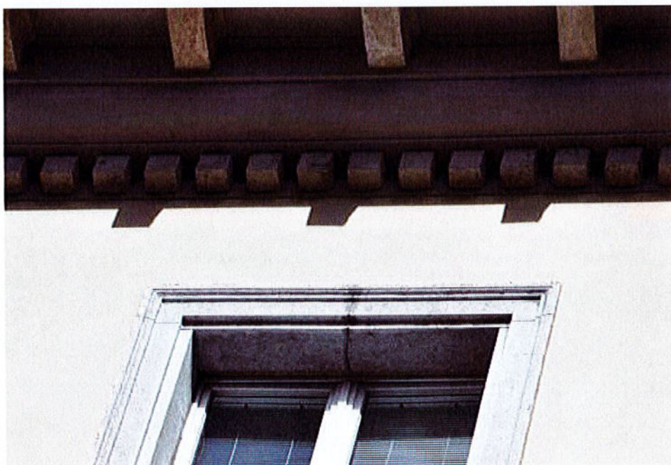
Foto 6-7: stucature mancanti nella cornice sottofinestra e fessurazioni passanti sull'architrave, ultimo piano
