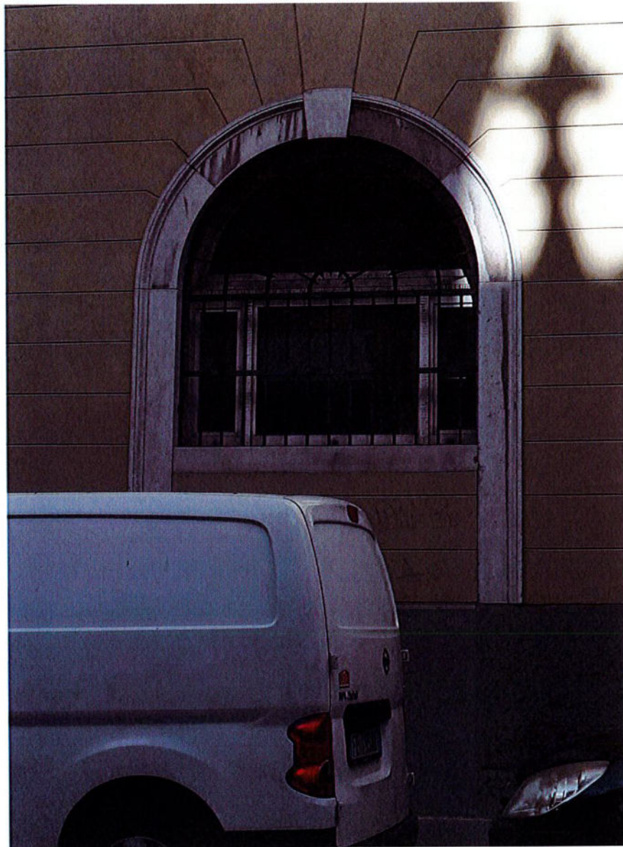
Foto 8: Tamponamento di un arco al pianoterra che, in origine, doveva essere una porta: da valutare assieme alla Soprintendenza e DL una sua eventuale riapertura, per ridare al prospetto l'originaria disposizione delle aperture.
